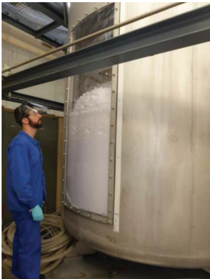
Figure 3 - Mousse de remplissage sur une cuve type SPF en inactif de 20 m 3 .
