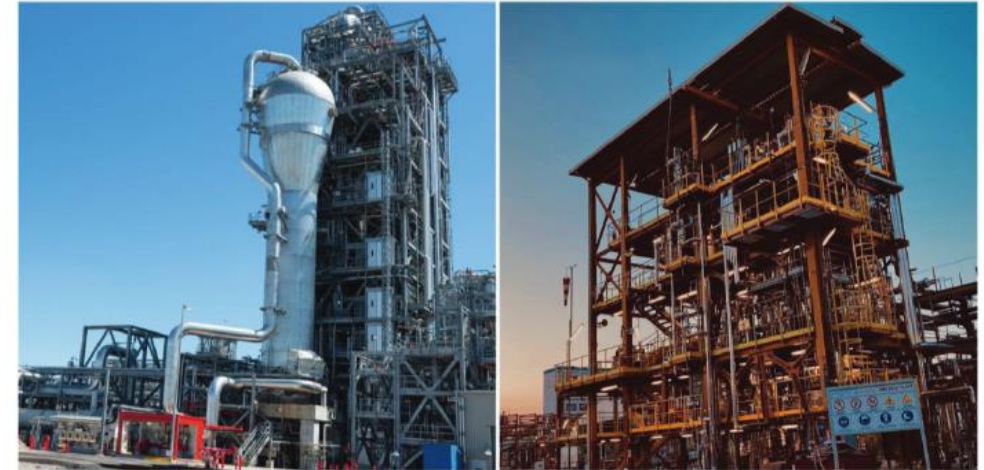
Réacteur multizones de polymérisation en phase gaz (Hyperzone PE Plant LyondellBasell (2022))
