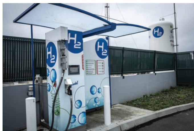
Figure 5 - Station de ravitaillement située à Nantes. Cette station est ouverte aux particuliers utilisant des voitures à hydrogène mais également aux utilitaires et aux bus. L'avantage de l'hydrogène par rapport aux véhicules électriques à batterie réside d'une part dans l'augmentation drastique de l'autonomie – un véhicule familial peut parcourir environ 100 km avec 1 seul kg d'hydrogène – et d'autre part dans la réduction tout aussi importante des temps de recharge puisqu'il est possible de faire le plein en quelques minutes seulement. © Jean-Claude MOSCHETTI/IMN/CNRS Photothèque.
