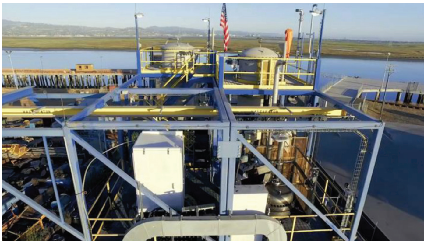
Figure 3 - Vue aérienne du pilote installé en Californie (Seaport).
