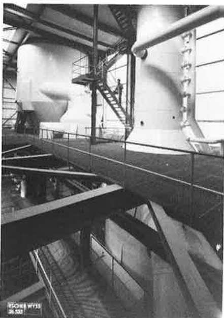
Vue partielle d'une installation d'évaporation Escher Wyss à thermocompression pour 40 t de sel par heure.
