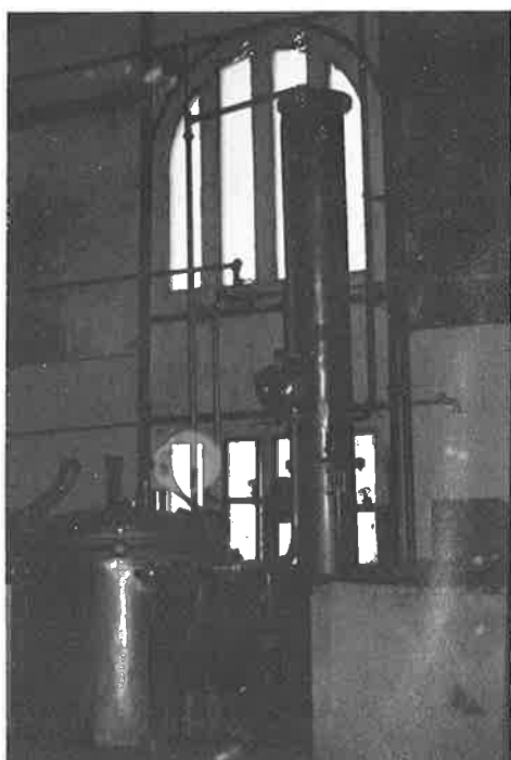
Partie supérieure d'un extracteur à solvants volatils.
