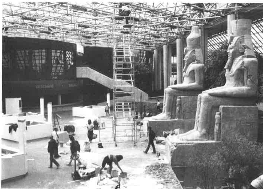
Installation du hall d'entrée des salles de conférences d'IRC 90 et Europlast (Parc international des expositions Paris-Nord, 12-14 juin 1990).
