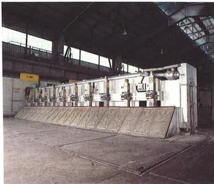
Photographie III A 2 : Cuve 295 kA de production d'aluminium - Dunkerque (Nord) - Documentation Aluminium Pechiney.
