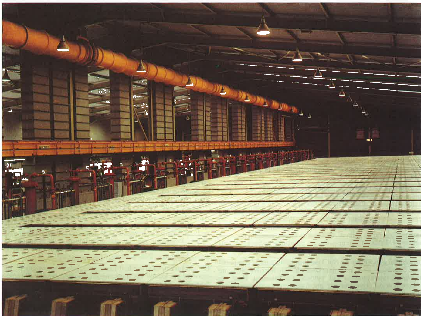
Photographie II A 1 : Salle d'électrolyse de Runcorn (U.K.) - Cellules à cathode de mercure pour la production de chlore/soude - Documentation I.C.I.
