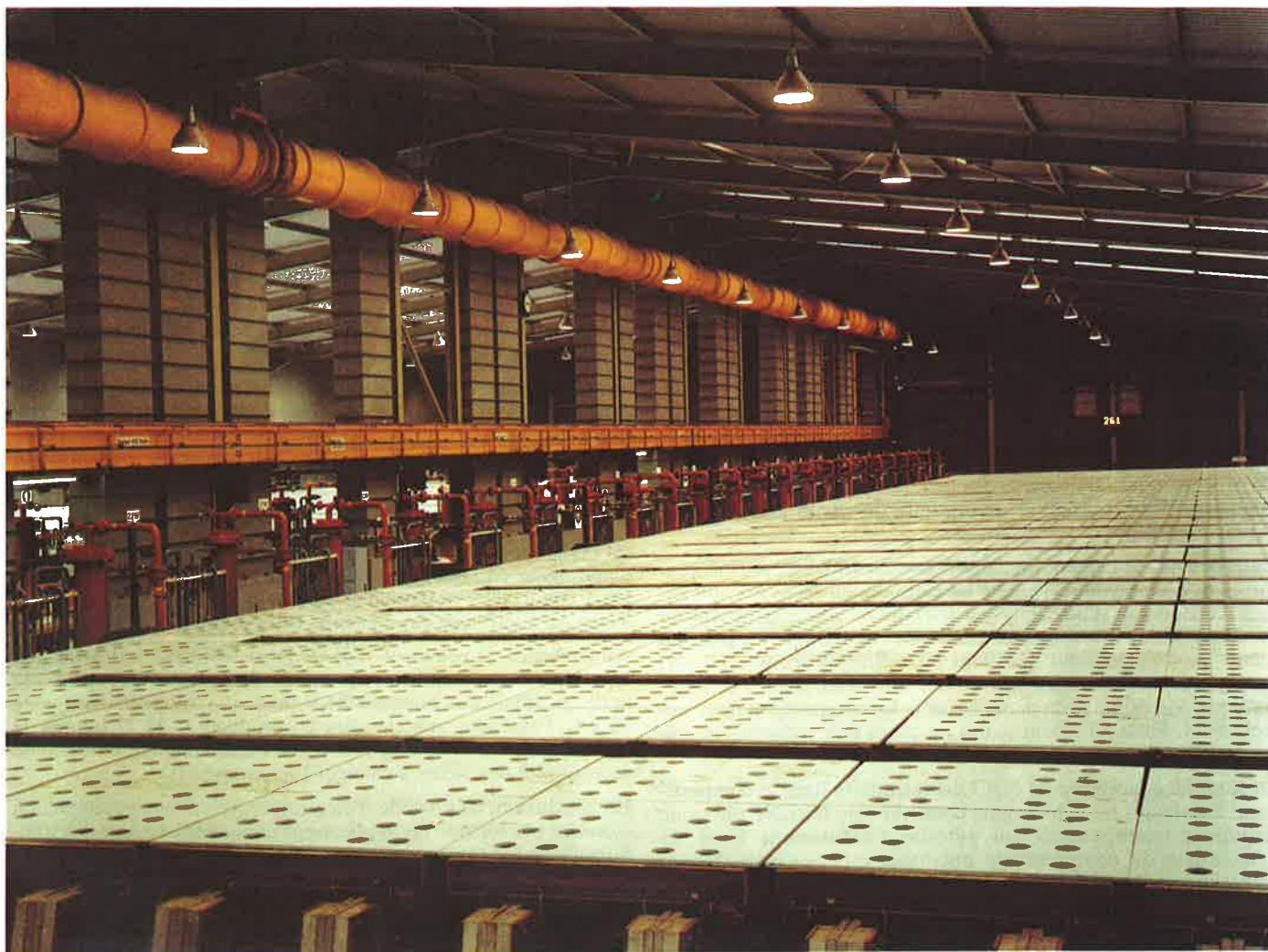
Photographie II A 1 : Salle d'électrolyse de Runcorn (U.K.) - Cellules à cathode de mercure pour la production de chlore/soude - Documentation I.C.I.
