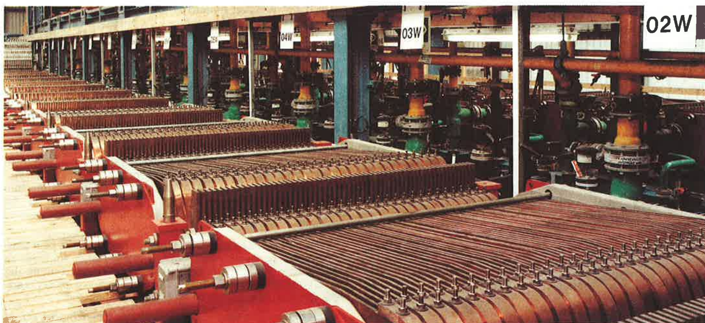
Photographie II A 3 : Salle d'électrolyse de Runcorn (UK) - Cellules à membrane I.C.I. type FM21 pour la production de chlore/potasse - Documentation I.C.I.
