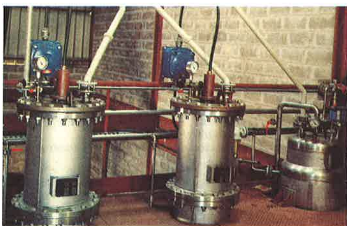
FIGURE 10. - Unité pilote d'électrosynthèse organique de la SNPE (Pithiviers). Électrolyseurs à anode soluble.
