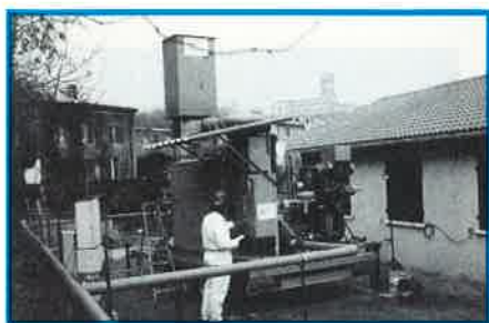
Plate-forme de venting sur départ réseau dépollution.
