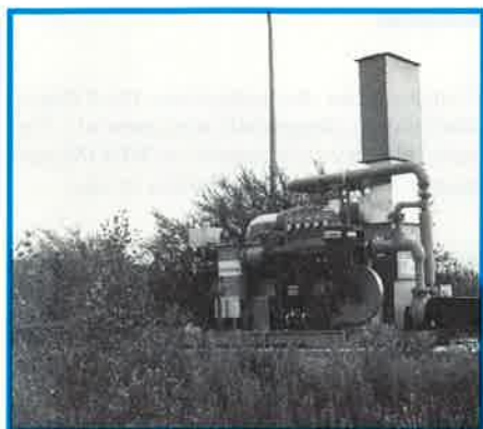
Plate-forme de venting.
