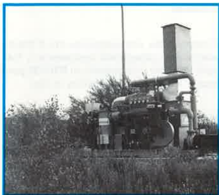
Plate-forme de venting.
