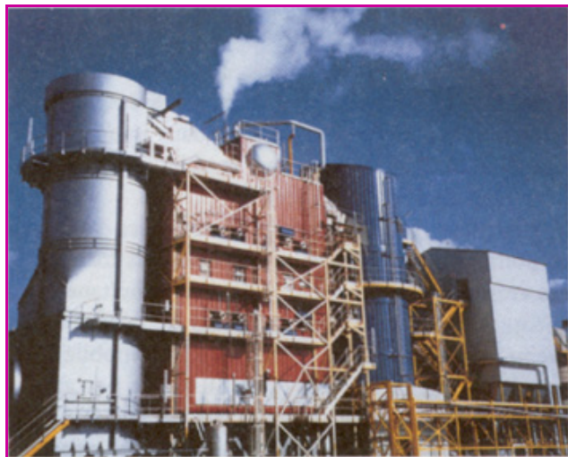
Figure 5 - Où le déchet toxique... se transforme en électricité. Dans cet incinérateur européen, les déchets les plus toxiques sont brûlés et produisent de l'électricité sans apport d'énergie extérieur (photo ©Merex).
