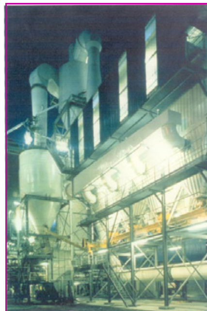
L'unité de valorisation thermique de Sotrenor (Courrières).
