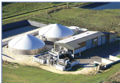
Site de méthanisation Gâtinais Biogaz, sur le canton de Château-Renard (Loiret). © Gâtinais Biogaz.
